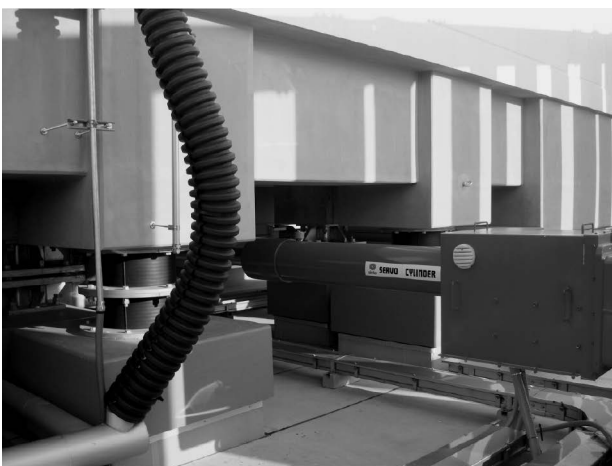
写真8 屋上実験室 免震装置 (アクチュエータ、積層ゴム支承)
